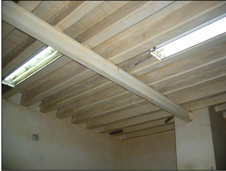
(لوحة ٧) سقف البدروم الخشبي
