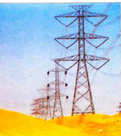
خط نقل الكهرباء من المنطقة الشرقية
