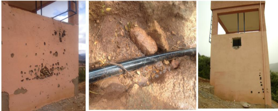
Planche photo4: le conflit entre deux douars a conduit à une destruction partielle d'un château d'eau au douar Ait Srghint.
