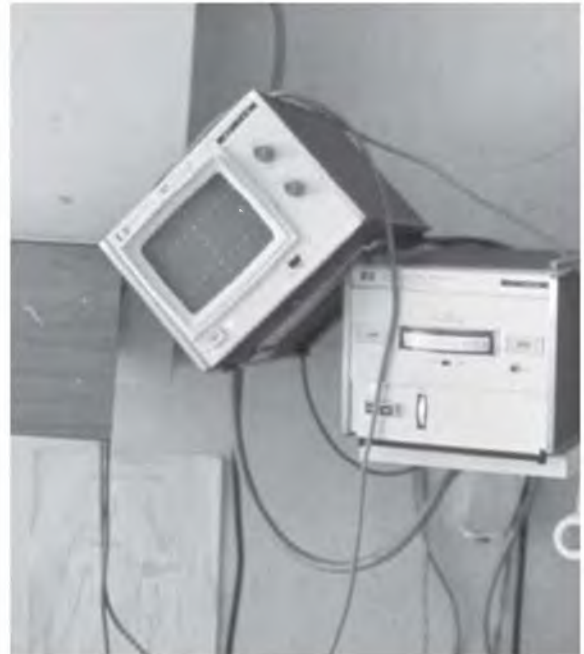
الشكل رقم (٧٦,٣). مولد مكدس بشكل غير صحيح.
