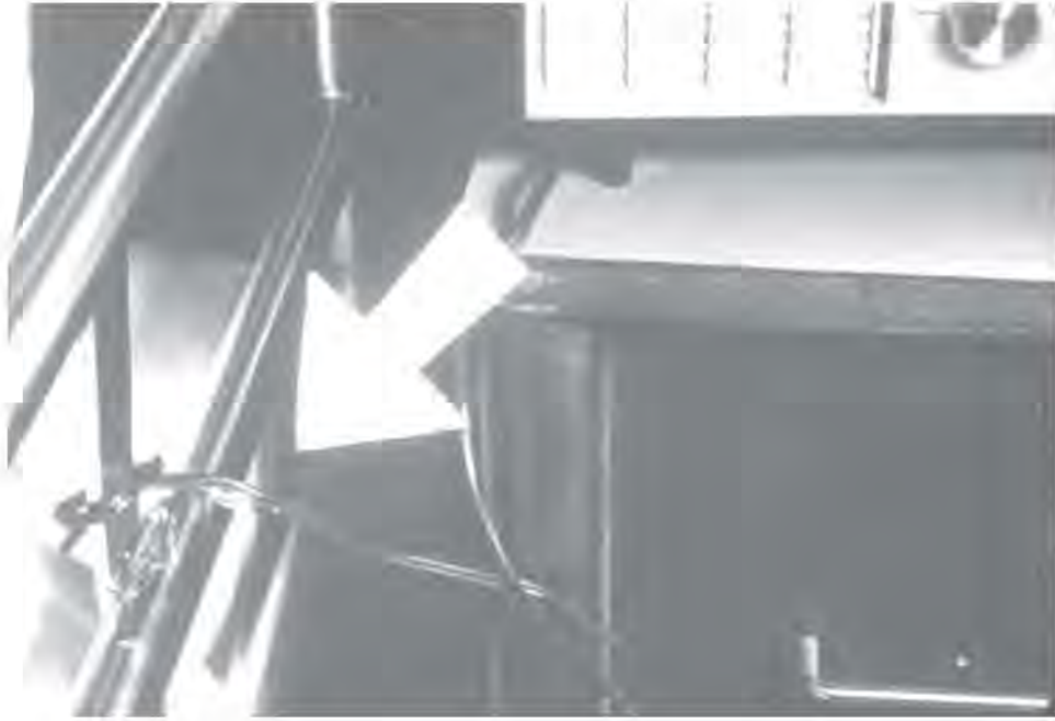
الشكل رقم (٩٥, ١٢). كبل كهربائي لراديو مع عزل مضطرب يلامس سكة السرير.
