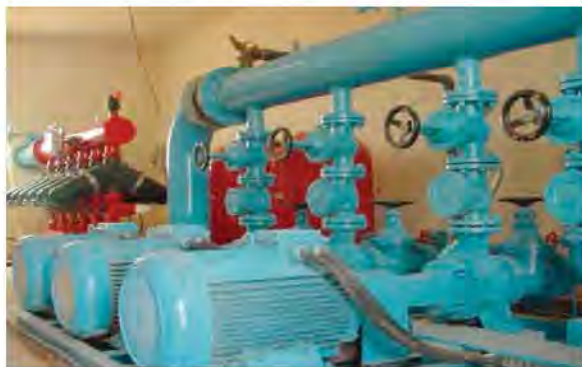
الشكل رقم (٢٦، ١١). محطة ضخ تعمل آلياً.
