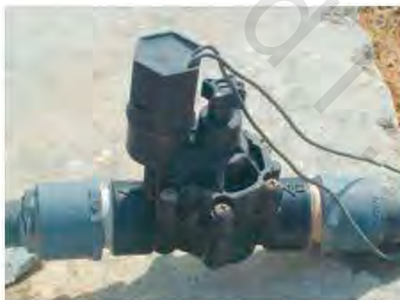
الشكل رقم (٢٧، ١١). صمام كهربائي يعمل بالتحكم الآلي.
