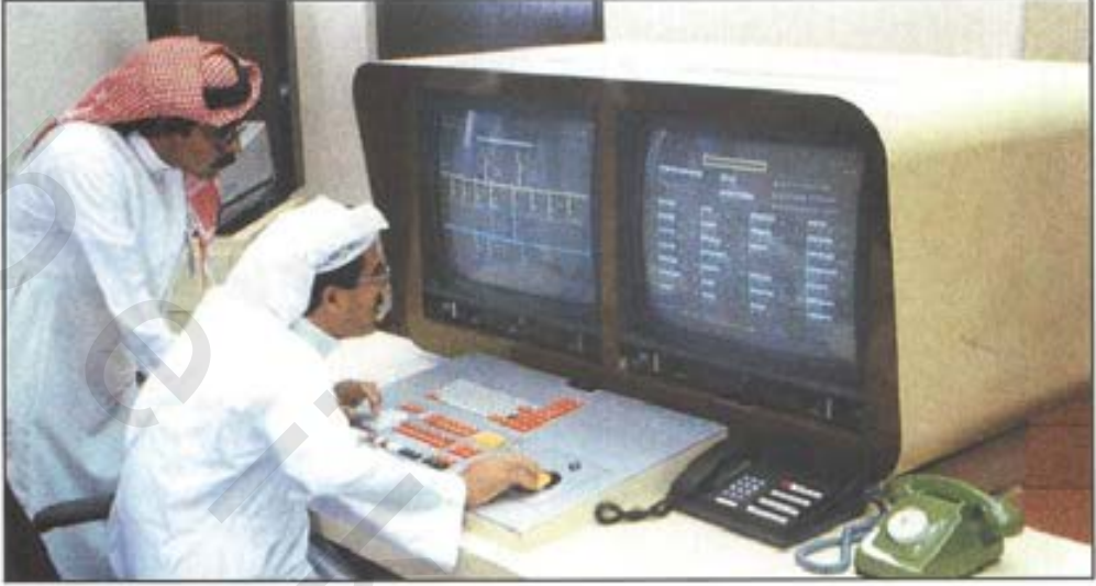
إحدى محطات التحويل الكهربائية
