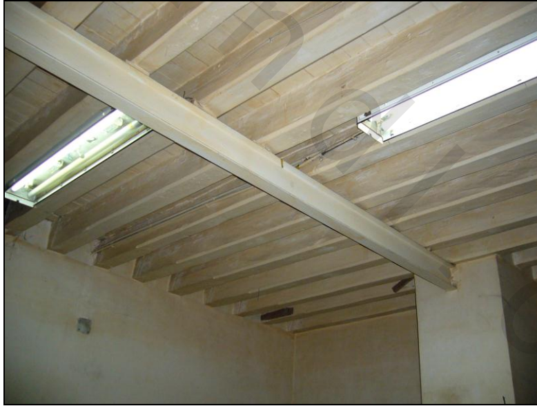
(لوحة ٧) سقف البدروم الخشبي
